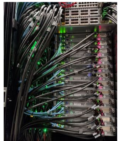
Abbildung 2: Rechencluster in RZ-Standort Wien
